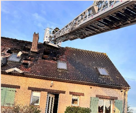
INTERVENTION POUR INCENDIE ST-GERMAIN- JANVIER 2023
