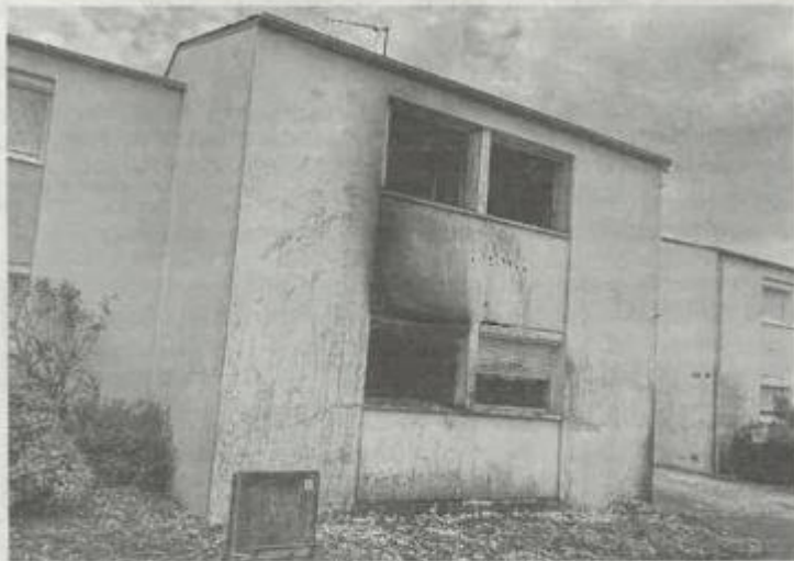
Le pavillon derrière Auchan, détruit dans un incendie suspect.
